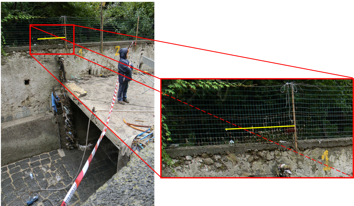
Figura 25 – Livello raggiunto dal flusso sull'estradosso dell'imbocco del tratto tombato del torrente Dragone
